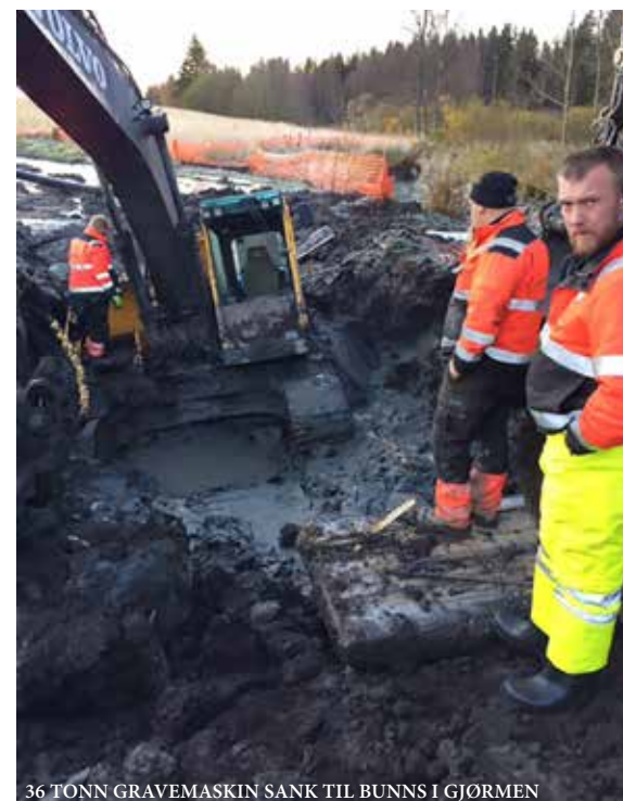
36 TONN GRAVEMASKIN SANK TIL BUNNS I GJØRMEN
