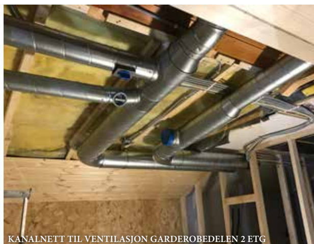
KANALNETT TIL VENTILASJON GARDEROBEDELEN 2 ETG
